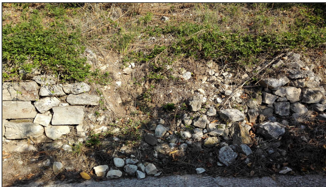
Fig. 13: Esempio di crollo di muretto a secco nei terrazzamenti della Valpolicella (da Dossier di candidatura al Registro nazionale dei paesaggi rurali storici, 2021).
